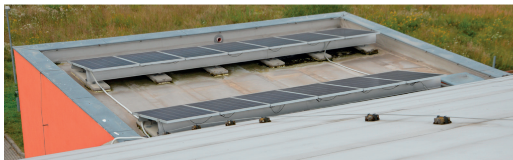
3) Fotovoltaické zařízení na střeše se zatěžovacími deskami
